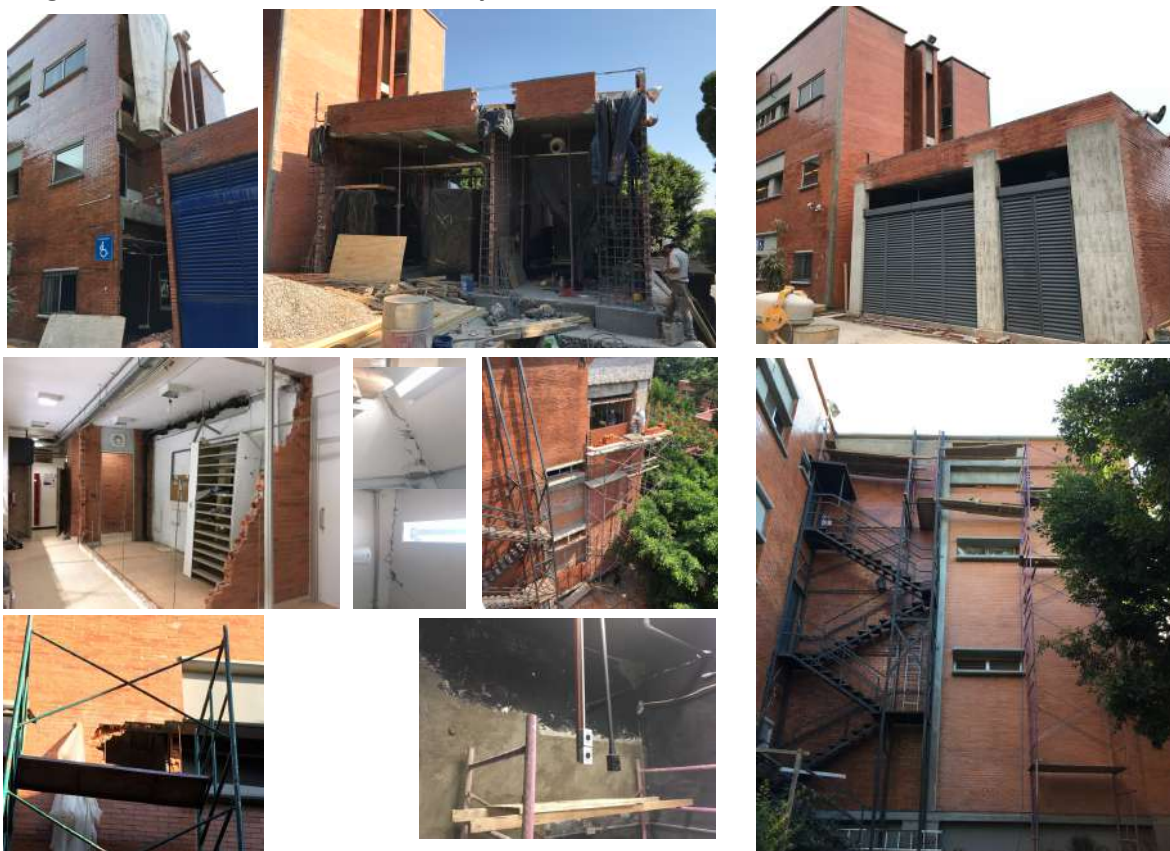
Figura 35. Efectos del Sismo de 2017 y Reconstrucción de los Daños.
